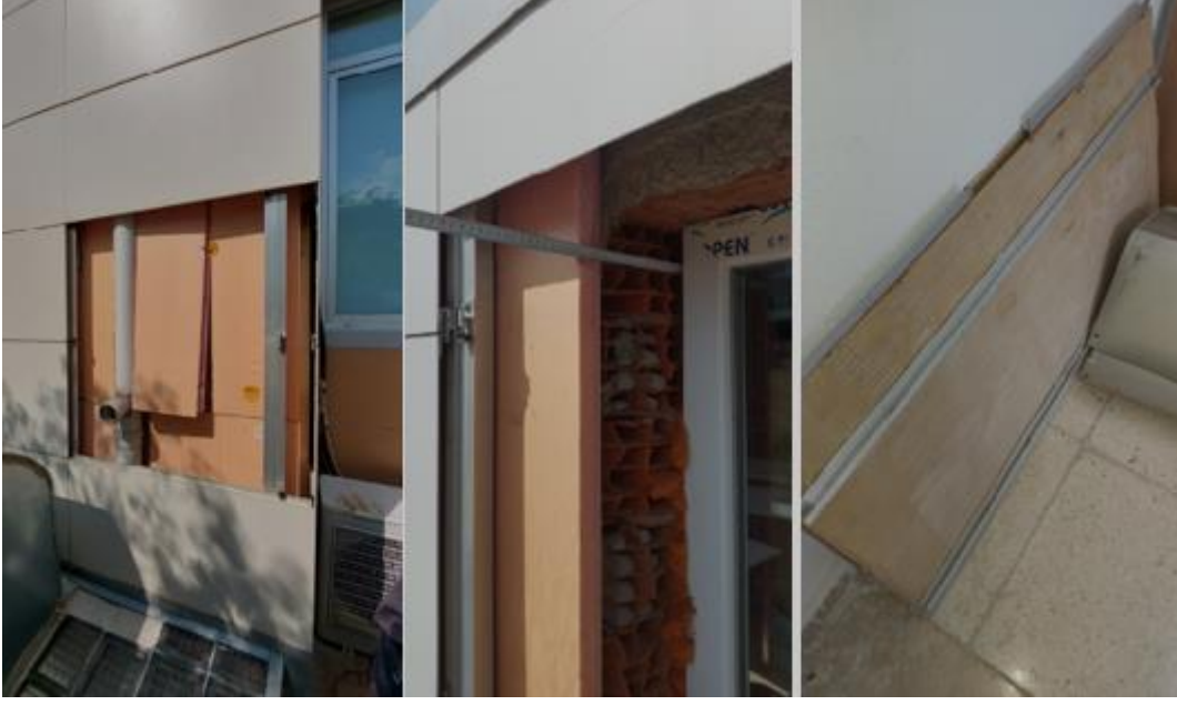
Şekil 8. SKS Menza Yerleşkesi Dış Cephe Bozulma Örnekleri
