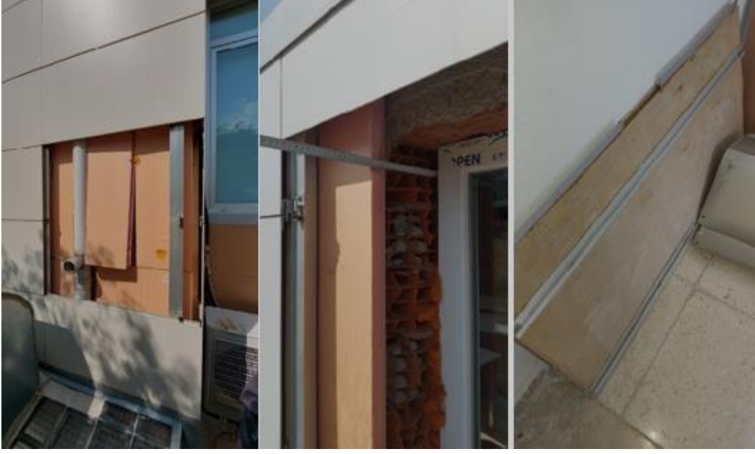
Şekil 8. SKS Menza Yerleşkesi Dış Cephe Bozulma Örnekleri
