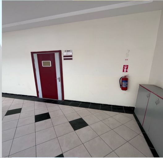
Fotoğraf 31. Yangın Söndürme Tüpü
